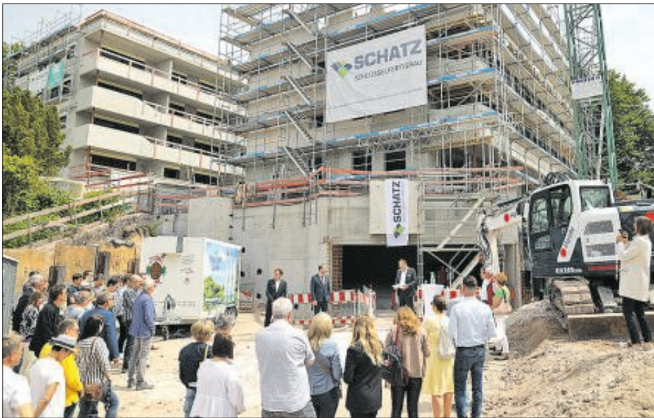
Am Donnerstag wurde „Deckenfest“ für das Bauvorhaben der Schatz Projectbau-Gruppe in der Schießtalstraße gefeiert. Dabei waren Vertreter des Bauträgers, der Stadt und der Baufirmen sowie Eigentümer.
