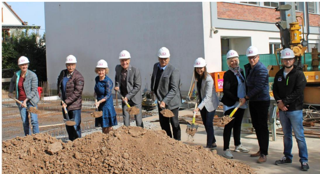
Gemeinderäte, Architekten, Schulleiterin, Bürgermeister und Schulrat greifen zum Spaten: Die Bauarbeiten können beginnen.
